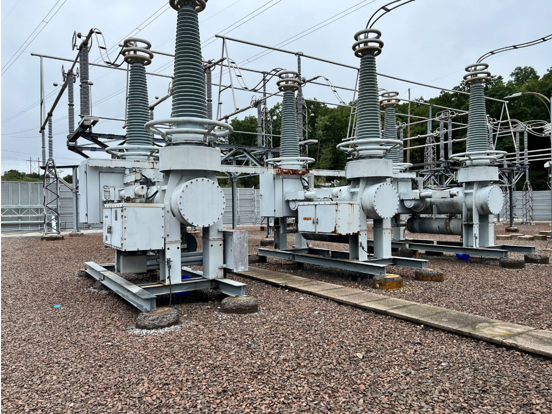
Vorhandener SF 6 Schalter
