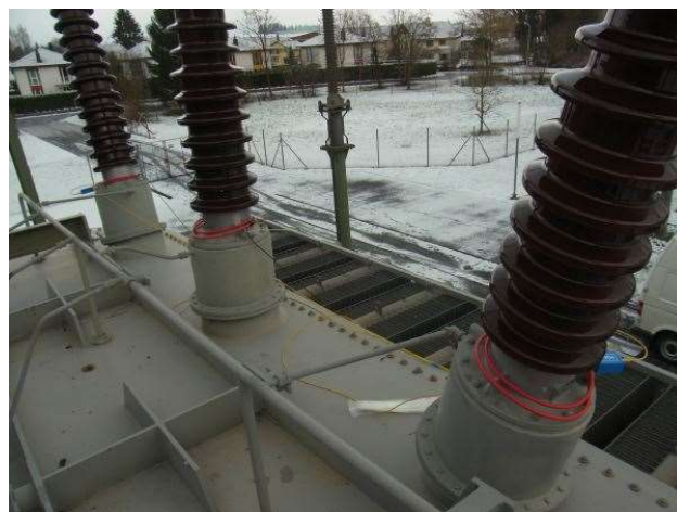
Bild 7 Transformator-Installation des Spannungsqualitäts-Messsystems (zusätzlich Rogowski-Stromzangen installiert)
