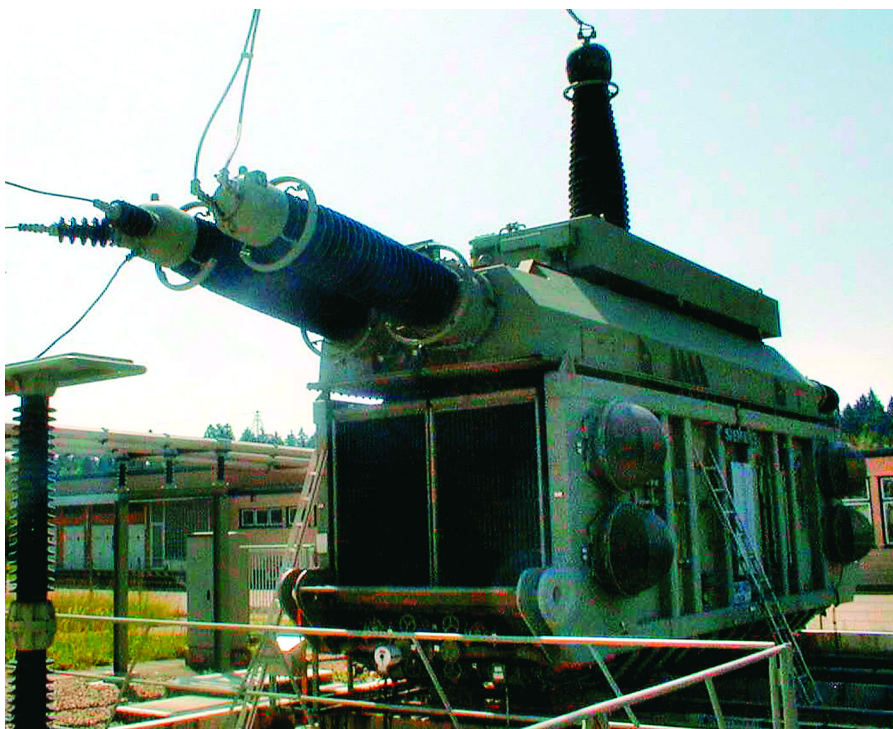
Bild 2. 200-MVA-, 380/220-kV-Einphasentransformator, an dem akustische, elektrische und elektromagnetische TE-Messungen durchgeführt wurden
