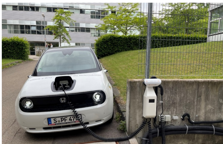
Fig. 2: Elektrofahrzeug beim Laden am AC-Ladepunkt Electric Vehicle while charging at the AC charging point.
