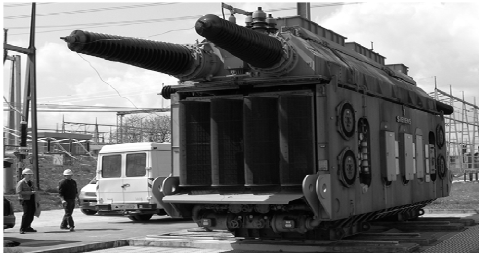
Fig. 2: 210-MVA-Netzkuppler mit TE-Aktivität bei Nennspannung 210 MVA Grid-Coupling Transformer with PD occurrence at nominal voltage
