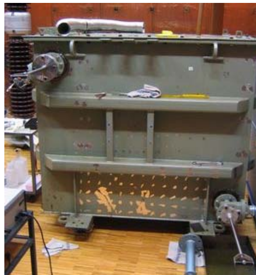
Fig. 3: Transformator-kessel mit zwei Ölflanschen und installierten UHF-Sensoren Test tank with two oil valves and two flange mounted UHF probes
