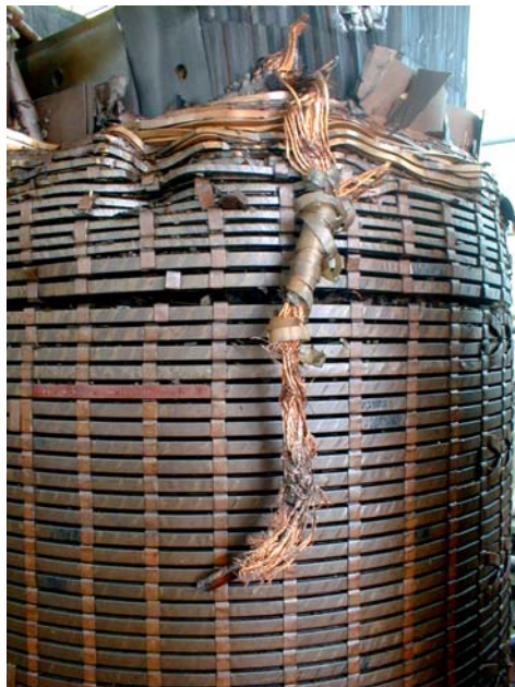
Fig. 1: Eine reale fehlerhafte Transformatorwicklung, bei der verschiedene Fehler aufgetreten sind.
