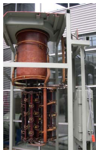
Fig. 2: Investigated tap changer Untersuchter Stufenschalter
